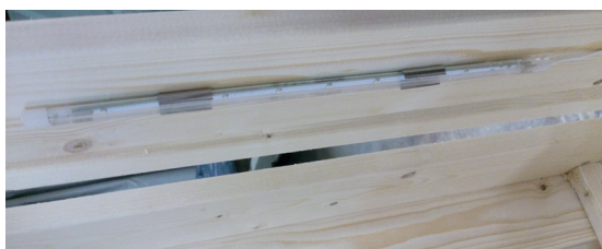
LED-belysning 12 V. Monteras under lavarna i bastudel, inkl transformator 220 V och stickkontakt.
